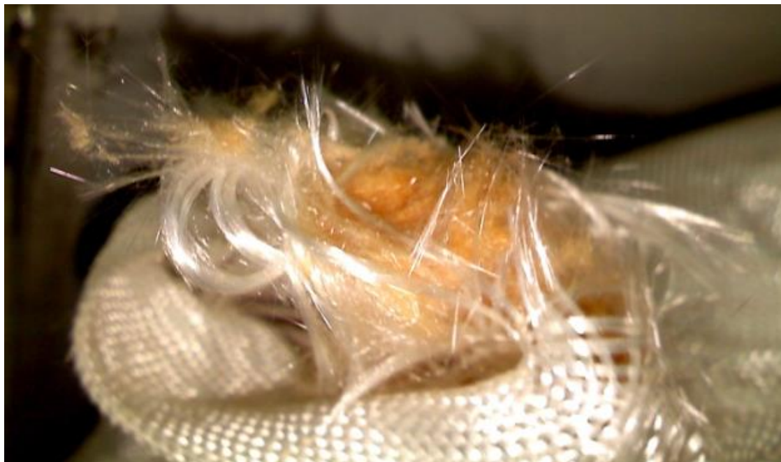
Figura 3 – Cordino isolante in fibra di amianto
