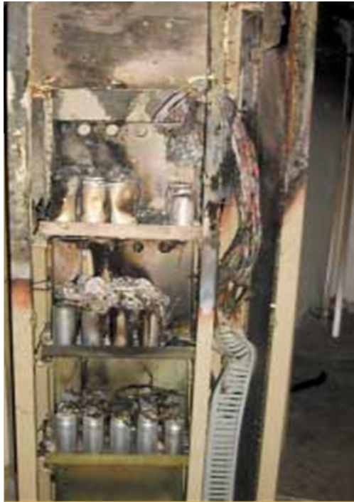
Scoppio di condensatori del sistema di rifasamento
